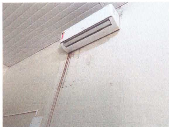
Foto 2 – Ar condicionado da recepção 01 aparentemente demonstra vazamento no dreno
