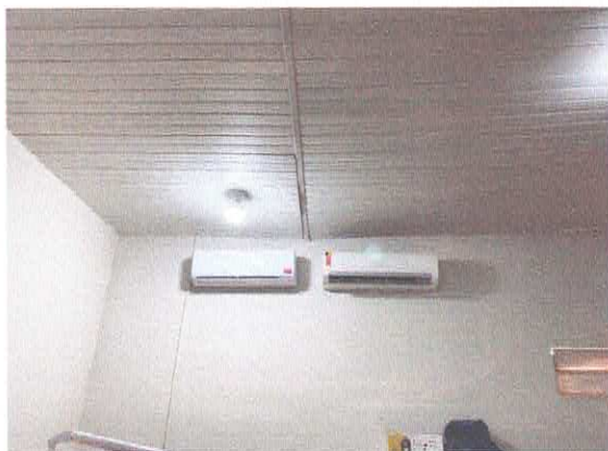
Foto 11 – Forro do consultório com defeito
