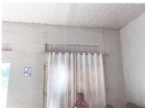
Foto 9 – Vazamento do telhado afetando a recepção 02
