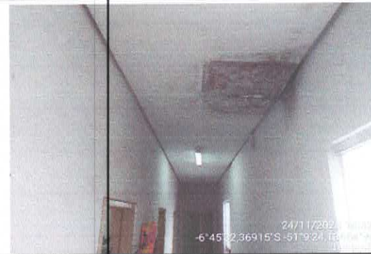
FORRO GESSO COM PROBLEMAS
