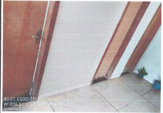
PORTAS E FFECHADURAS DEFEITUOSAS
